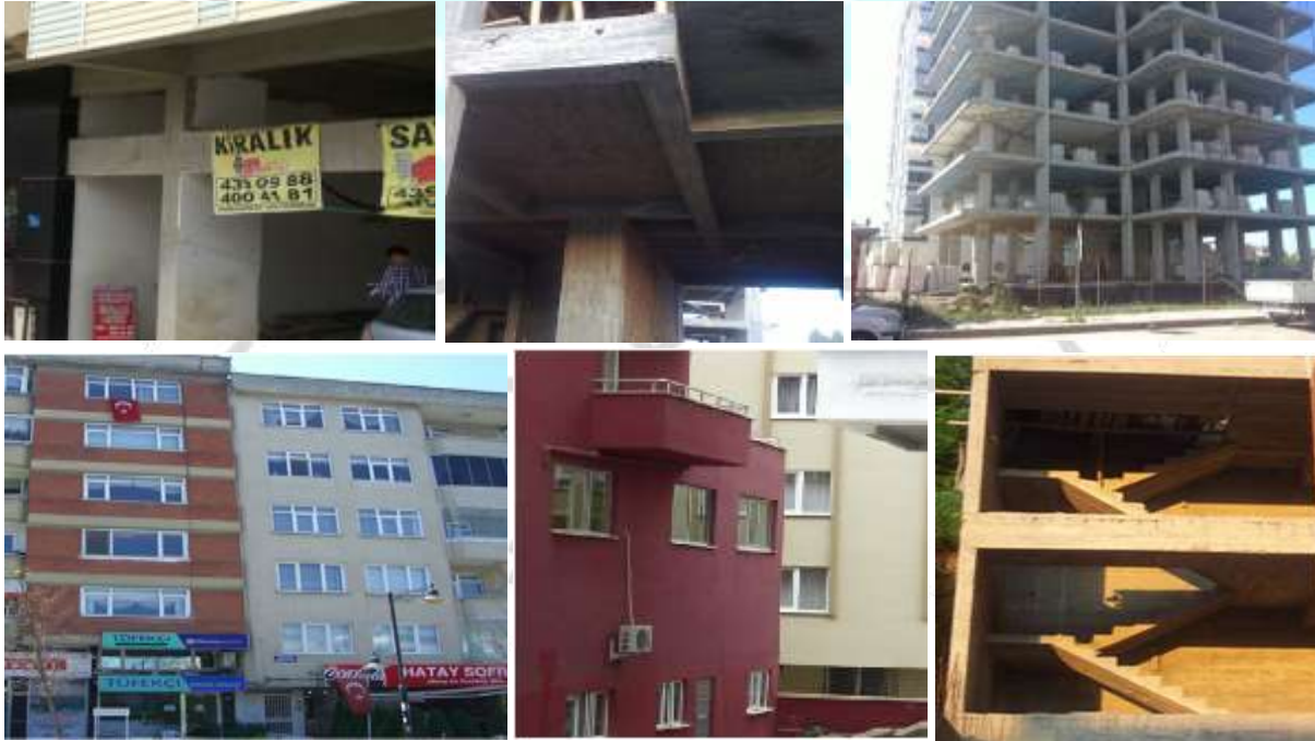
Şekil 3. Kısa kolon, Saplama kiriş-saplamanın saplaması, Asimetrik yapı, Bitişik nizamda kat düzeyi ve kot farkı, Yatayda düşeyde girintili çıkıntılı yapılar, Rijit merdiven örnekleri
