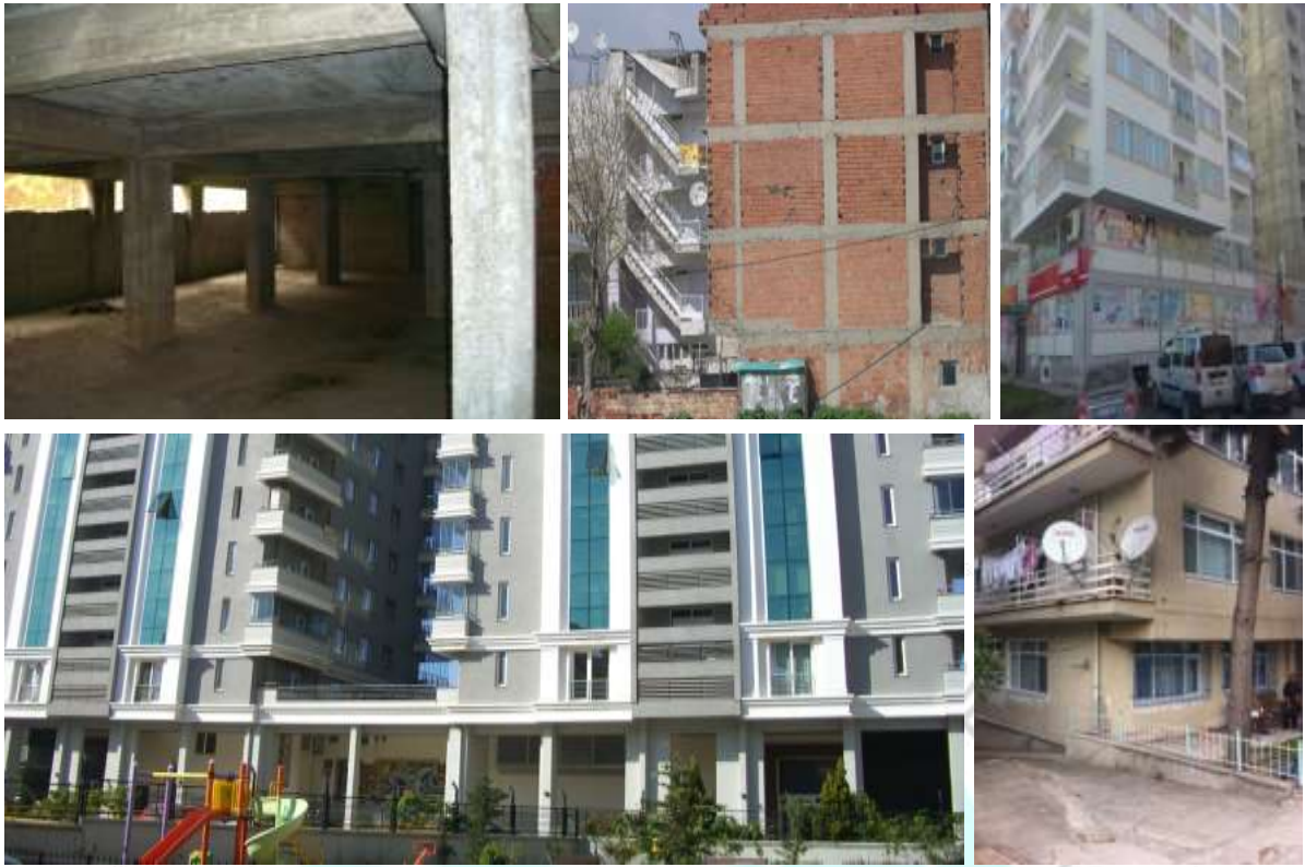
Şekil 4. Kolon perde rijitliklerinin planda x ve y yönünde düzgün dağıtılmaması, Süreksiz kolon- kiriş- perde, Çıkmalı yapıda köşe kolon veya uç kiriş, Zayıf kolon kuvvetli kiriş, Kot farkı olan arazide temel kot farkı örnekleri
