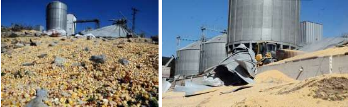
Görsel 6. Depremin mısır silolarına vermiş olduğu zarar 12
