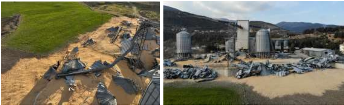
Görsel 5. Depremin buğday silolarına vermiş olduğu zarar [11]
