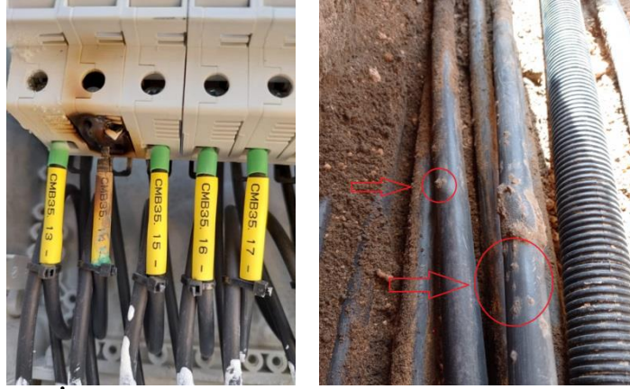
Görsel 6. (a) İnverter bağlantı kabloları, (b) Yeraltı iletim hattı kabloları
